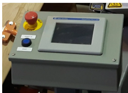
CCP - PANNEAU DE CONTRÔLE AVEC INTERFACE OPÉRATEUR
